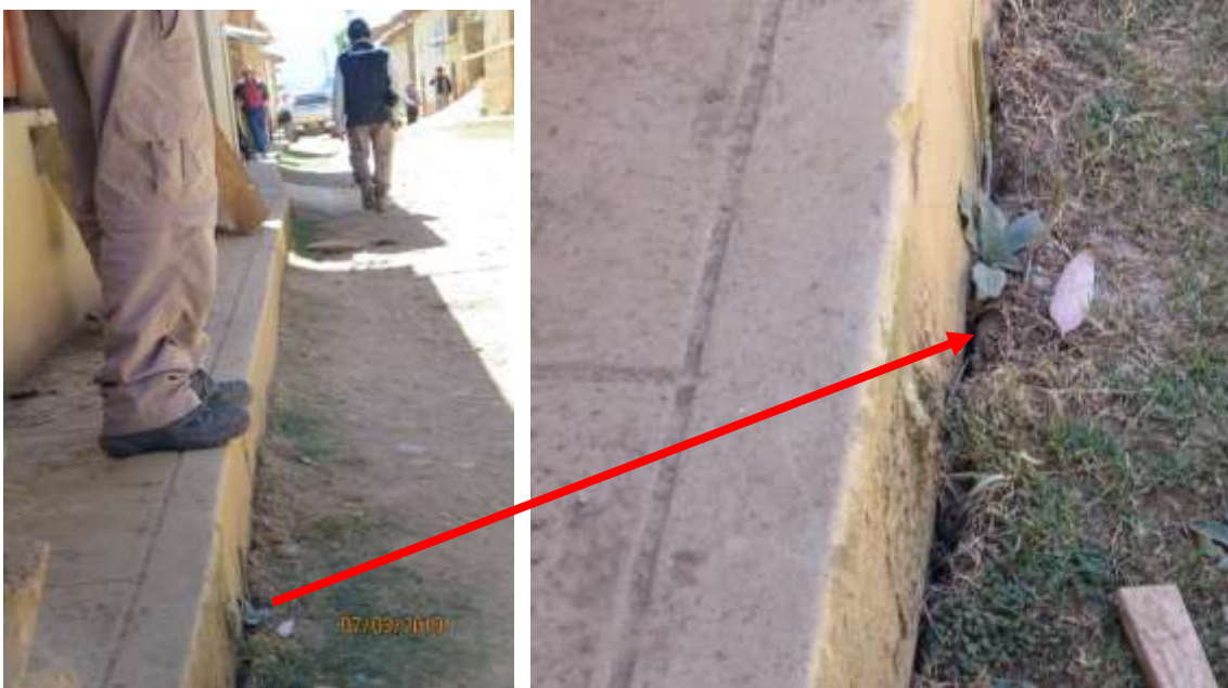
Fotografía 7. Separación entre el suelo y la vereda, índice del desplazamiento del terreno.
