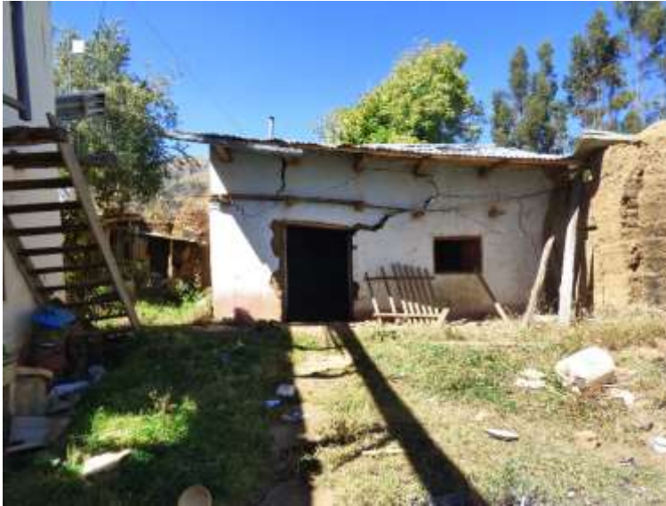
Fotografía 11 Viviendas afectadas por el asentamiento del terreno.
